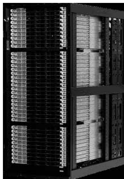
Рисунок 4. Шкаф вычислительной системы
